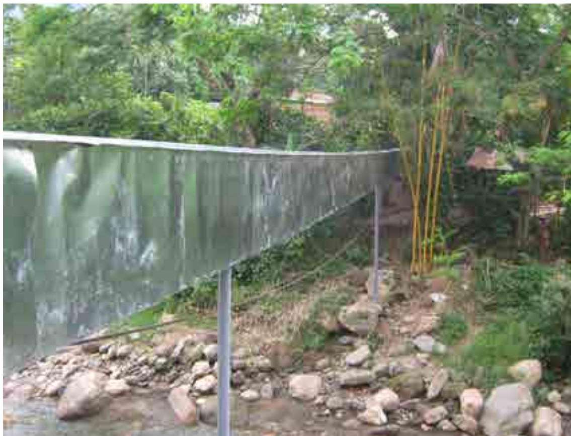
Apoyos con tubería petrolera de viaducto, sistema Playa Rica
