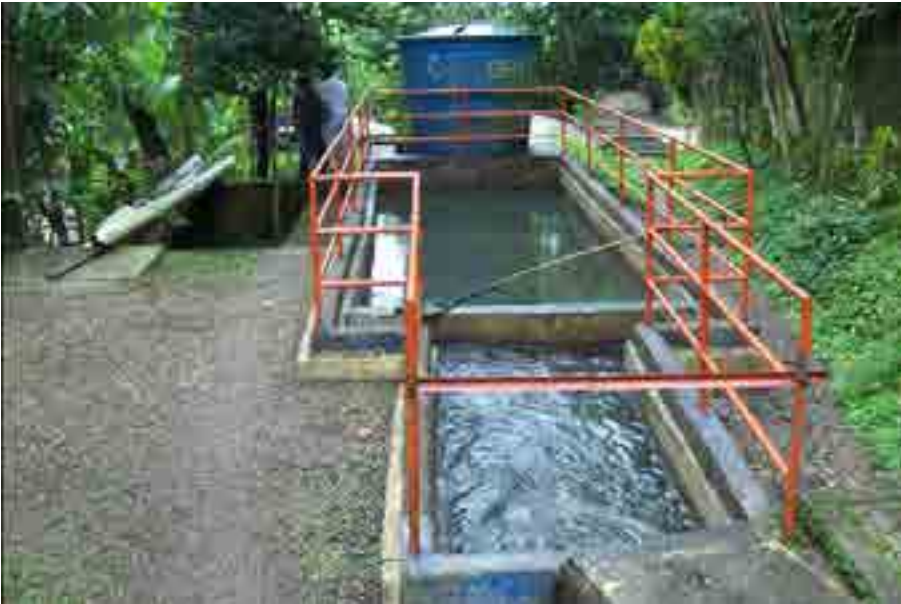
Desarenador del sistema ESPO-Ceiamba
