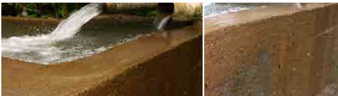
Desborde del desarenador
