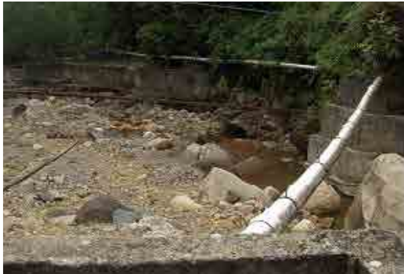
Tubería de aducción del sistema Playa Rica
